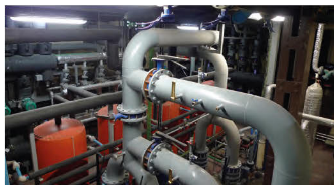
Rénovation d'un immeuble construit en 1912 situé au 67/69 Avenue Victor Hugo, 75016 Paris// Local technique - machine à absorption
