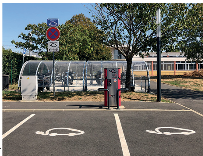
Bornes de recharge électrique installées à Rungis
