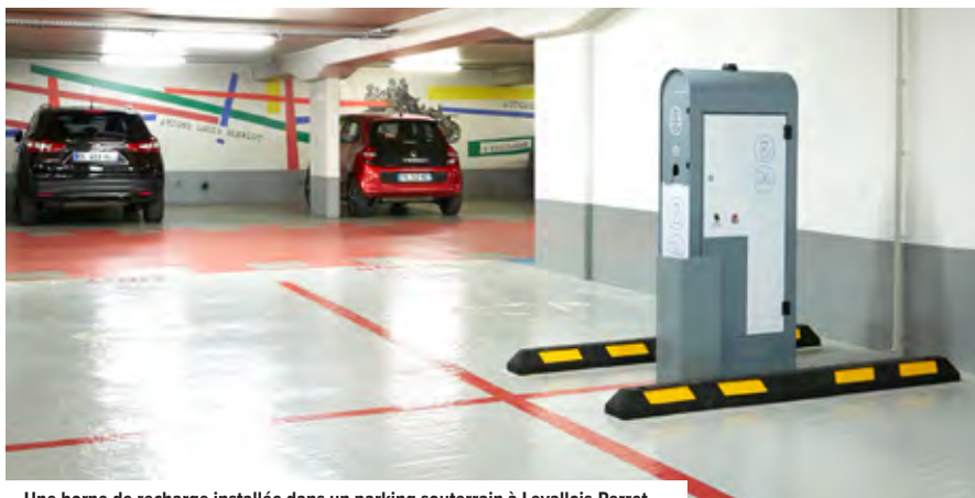
— Une borne de recharge installée dans un parking souterrain à Levallois-Perret.
