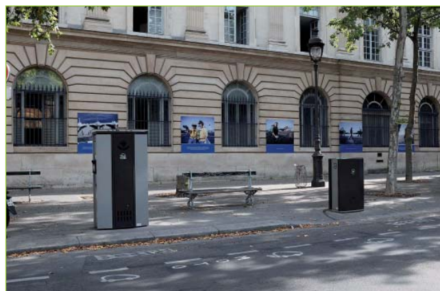
Réseau de bornes de recharge électriques Belib'
