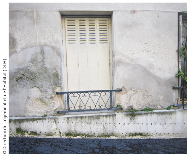
Remontée d'eau capillaire, rue Pradier, Paris 19 e
