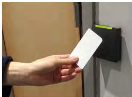
Clés électroniques permettant l'autonomie des équipements.
